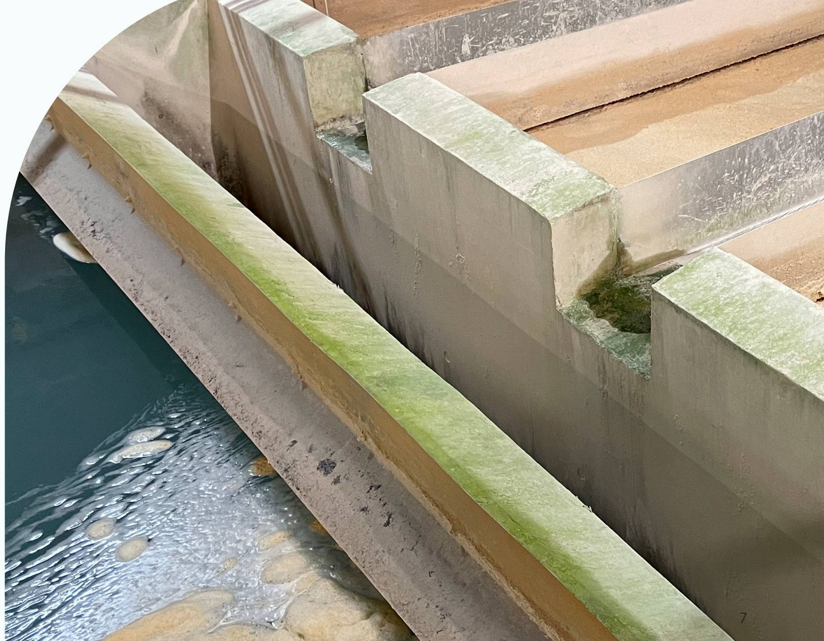
Bassin de dénitrification
