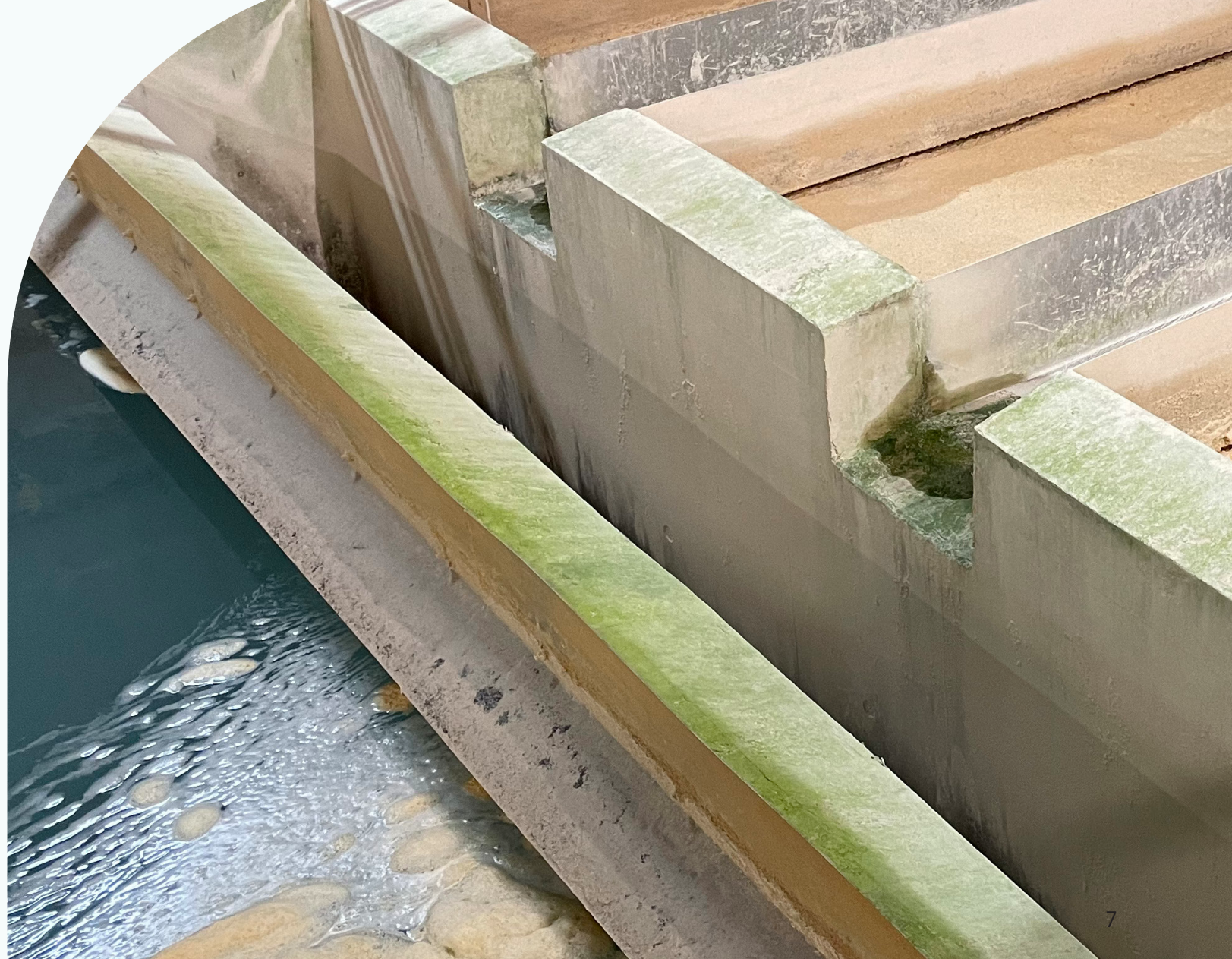
Bassin de dénitrification
